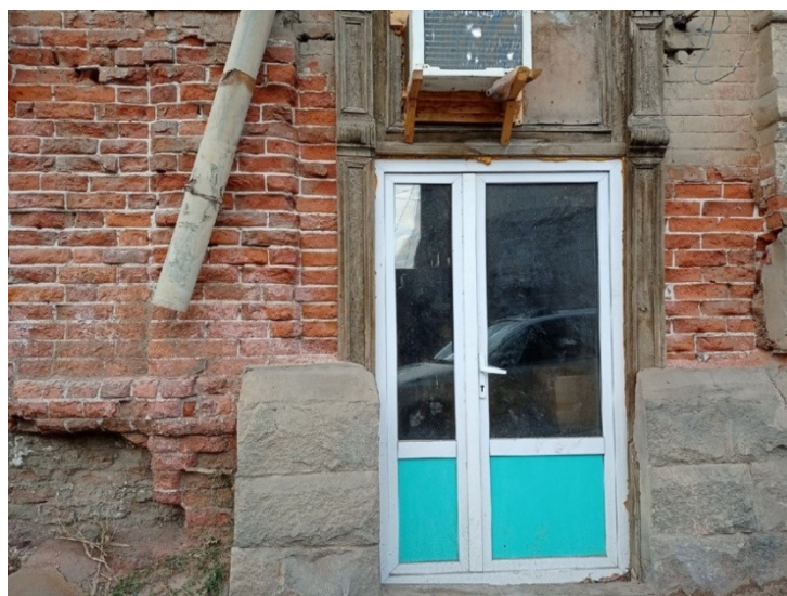
Рис. 2. Фрагмент фасада «Городской усадьбы XIX века» с дефектами
